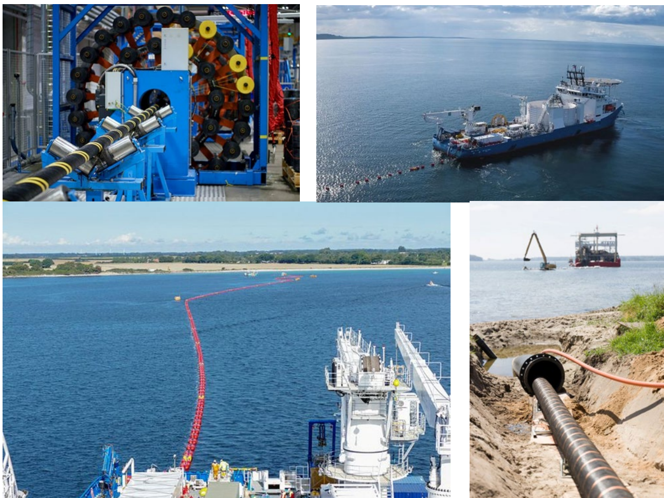
Figur 25. Uppe till vänster: Tillverkning av kablar (här sätts garn på ytersidan av kablarna). Uppe till höger: Installationsfartyg för kablar. Nere till vänster: Kabel in mot land. Nere till höger: Landtag. Källa NKT
