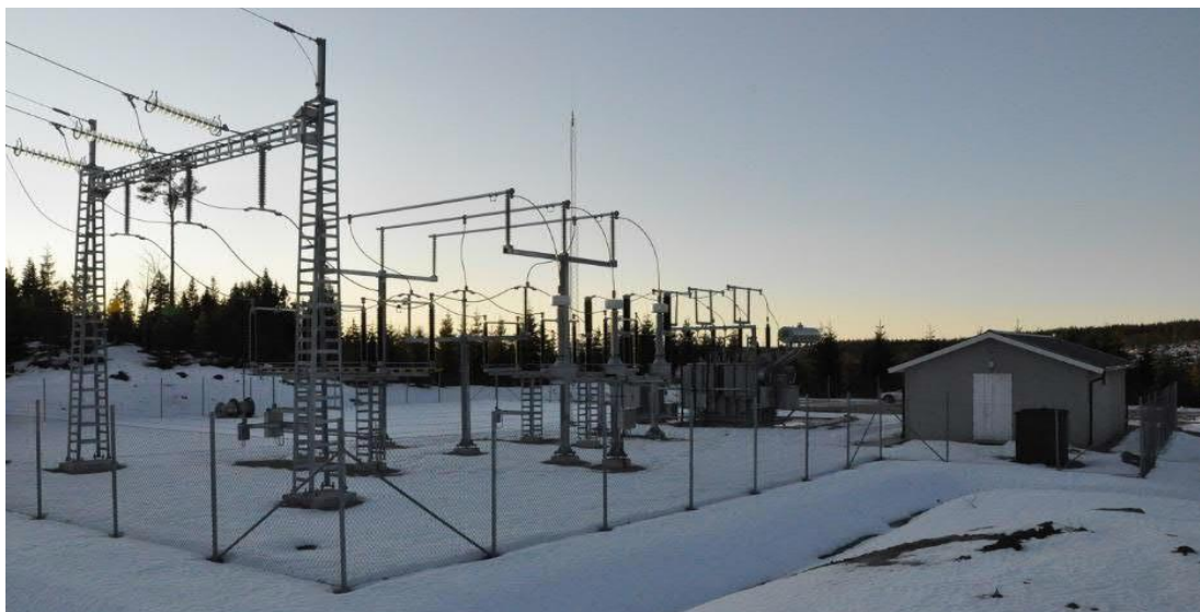
Figur 16: Foto över utomhusställverk vid Upprämnen i Dalarna som ägs av Ellevio.
