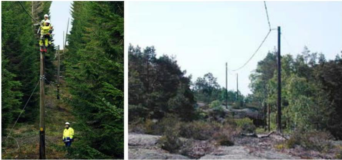
Figur 14: Exempel på utförande med hängkabel. Foto: Vattenfall
