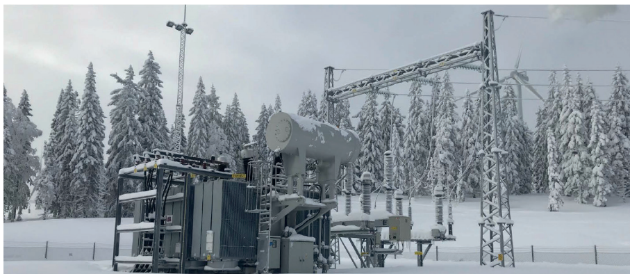
Figur 18. Exempel på 145/36 kV krafttransformator vid en fördelningsstation
